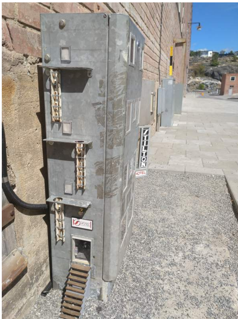
Foto 9. Instalación de Anonymouse, contador de luz, hotel para ratones. Hotel "Stilton". Junio 2018.
